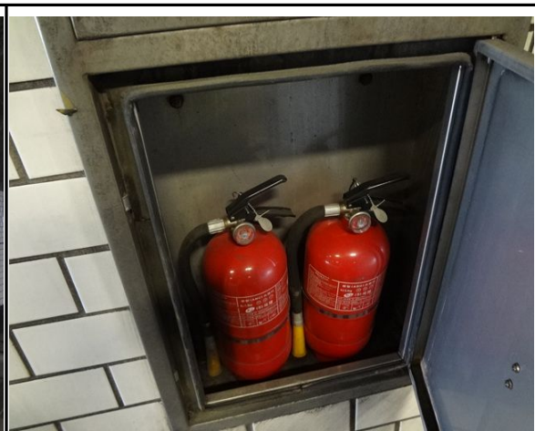
상행선 소화기 전경
