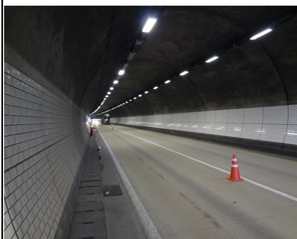
상행선 조명시설 전경
